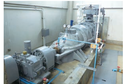
整備後のポンプ
