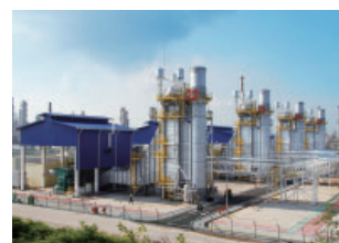
ペトロナス ベナビサン(マラッカ) コージェネレーションプラント プラント設備(マレーシア)
