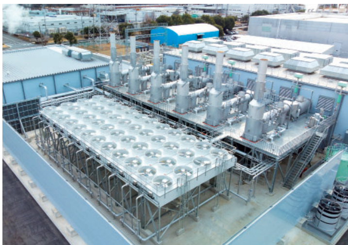
補機エリア(排ガスボイラ・ラジエター廻り)
